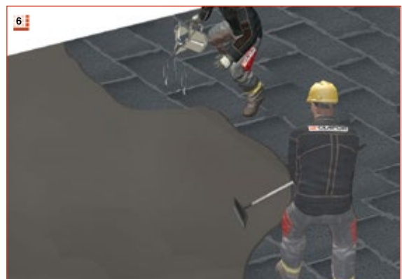
6 GLAPOR flex Heißbitumenmasse ausgießen und mit einem Gummischieber auf der Schaumglasoberfläche verteilen. Deckabstrich mit GLAPOR flex Heiß- bitumen. Verbrauch ca. 2,0 kg/m 2 .
